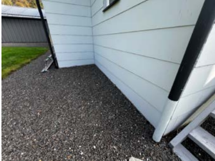
Utslipp rett i terrenget like ved grunnmur.
