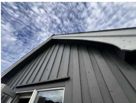
Værslitt og oppsprukket bordkledning.
