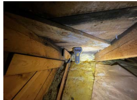
Fuktmåling, tørre verdier.
