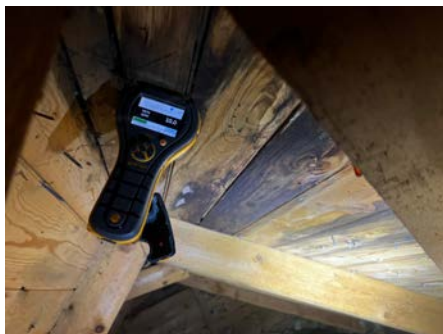
Fuktmåling, tørre verdier.
