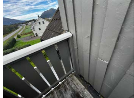
Værslitt og oppsprukket bordkledning.
