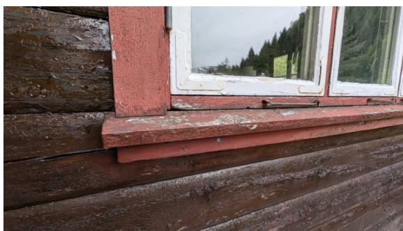
Vinduene i hytta har kort gjenværende levetid.
