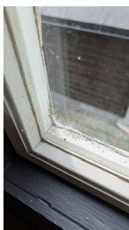
Vinduene i hytta har kort gjenværende levetid.
