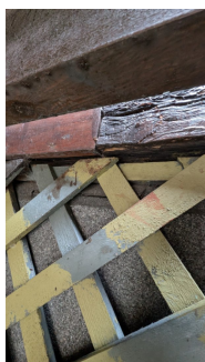
Fuktskadet tømmer sett fra utsiden under terrassen.
