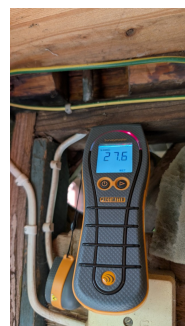
Fuktskadet tømmer sett fra innen/undersiden.
