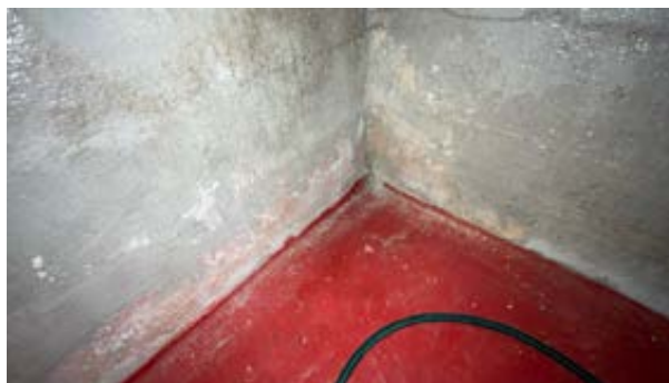
Visuell fuktvandring gjennom yttervegg mot terreng i form av salt/kalkutslag på unnvendig vegger.
