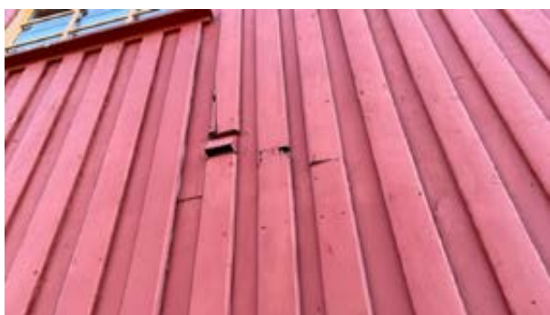
Stedvis råteskader i bordkledning.
