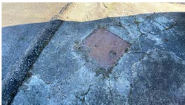
Utvendig stakepunkt, ikke besiktiget (fastfrosset)
