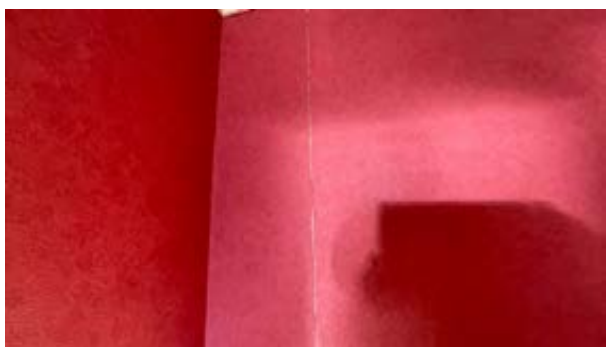
Sprekker i tapetskjøter.
