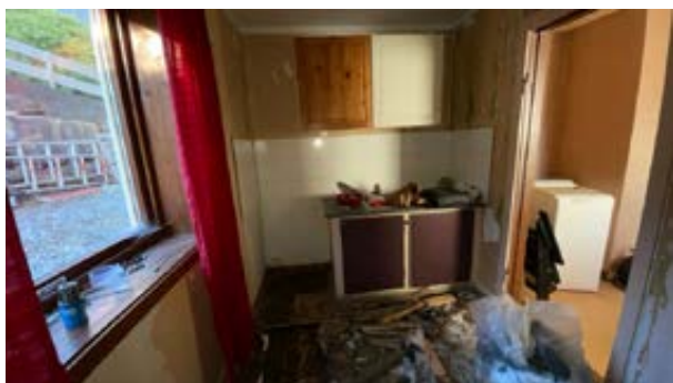
Ingen ventilering av kokesone.
