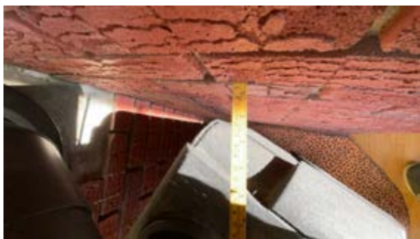
Ikke tilstrekkelig avstand mellom ildsted og brannmur.
