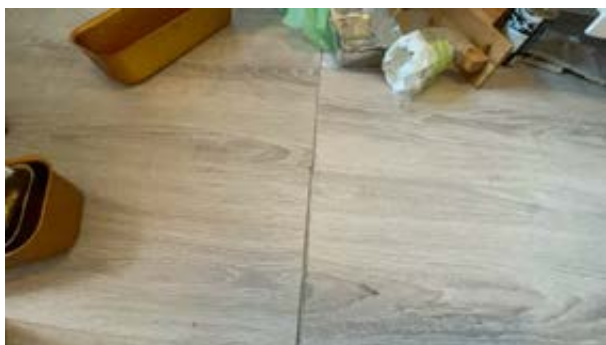
Sprekker i laminat/skjøter.
