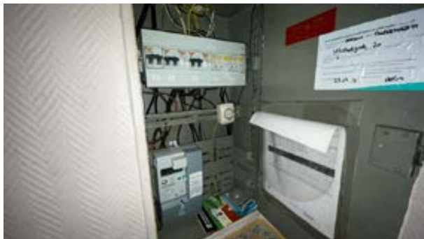
El-skap i 2. Etasje.
