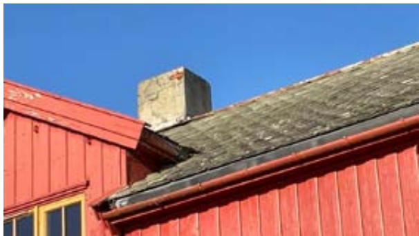
Sprekker i puss/over tak.
