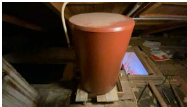
Varmtvannsbereder på loft.
