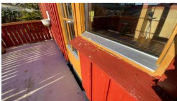
Manglende beslag på vindusbrett.
