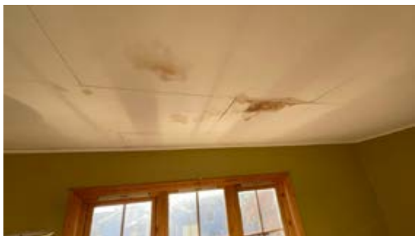
Fuktskader i tak på stue.
