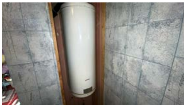
Varmtvannsbereder bad sokkeletasje.
