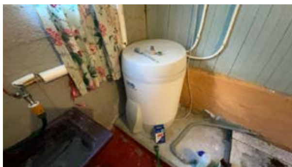
Varmtvannsbereder i vaskerom sokkeletasje.
