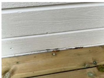
Råteskadet kledning langs terrassebordet.
