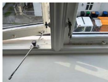
Slitt maling på soveromsvinduene.
