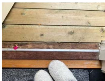
Terskel på ytterdør ved badet har påbegynnende råteskade.
