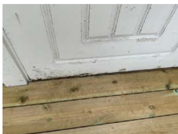
Slitt dør på tilbygget.
