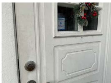
Slitt dørblad med fuktsvell.
