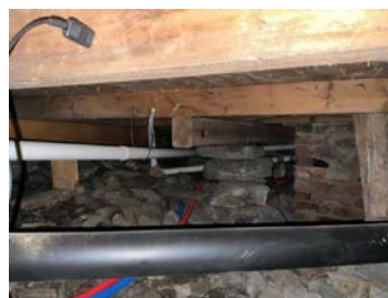
Manglende understøtting av bjelkelaget.
