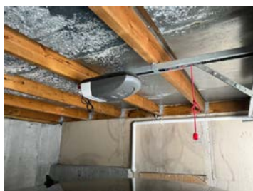
Fuktskjolder og korrosjon i dryppsikringen.
