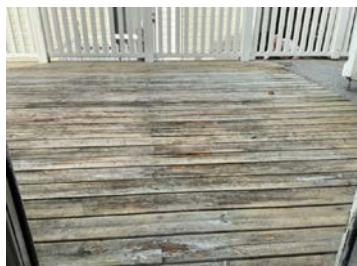
Råteskade i terrassebordene.
