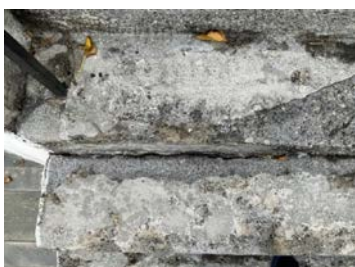
Sprekker i betongtrapp.
