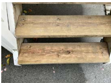
Påbegynnende råteskader i inntrinn.
