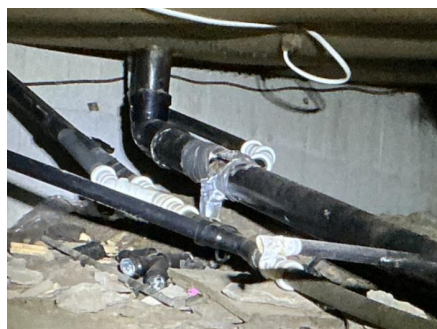
Avløps-rør er tapet over i skjøt.
