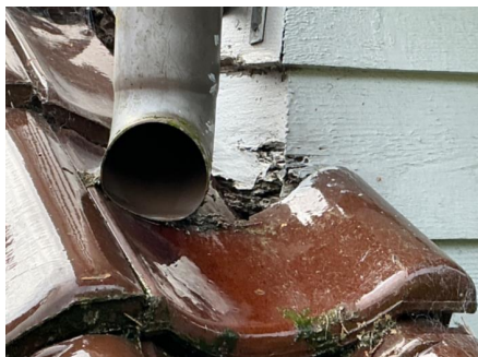
Fukt-råte på vegg mellom bolig og garasje.
