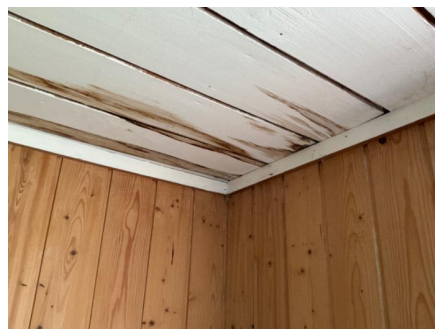
Synlige fuktmerker i tak. Ved fukt-søk er det ikke registrert unormale verdier.
