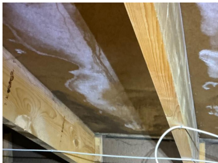
Synlig svertsopp/muggsopp på deler av sutak.
