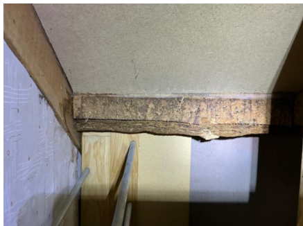
Fukt-skjolder på tak-gjennomføring til pipe.
