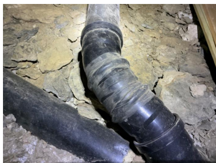
Avløps-rør er tapet over i skjøt.
