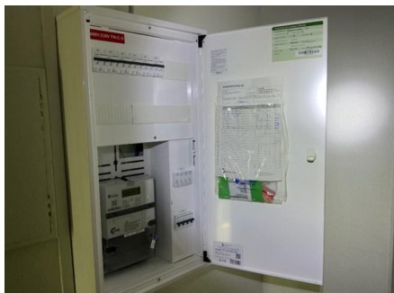
Sikringsskap står i gang 1 etasje.
