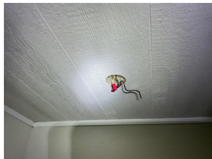
Deksel på takboks er ikke montert.
