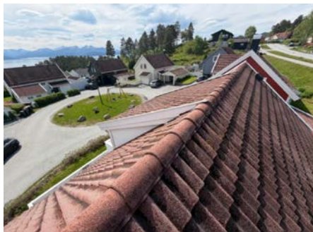
Oversiktsbilde av taktekking. Takset fremstilles å være i god stand alder tatt i betraktning.
