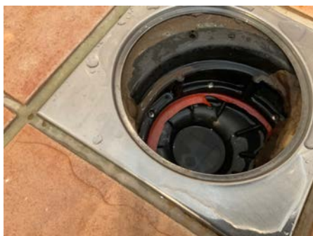
Sluk i dusjsone.
