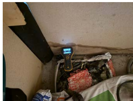
Fuktskadet veggplate i boden mot nordvest. 22,6 vektprosent er vått.
