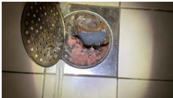
Sluk i bad i underetasje
