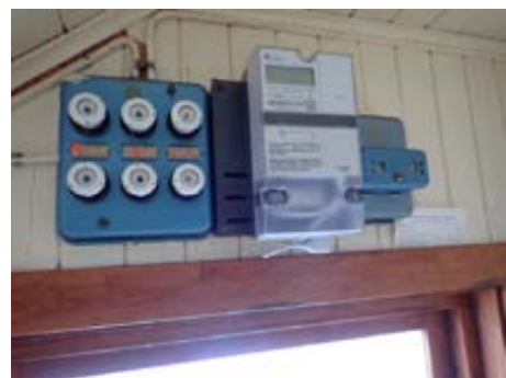
El-anlegg på vegg på loft.
