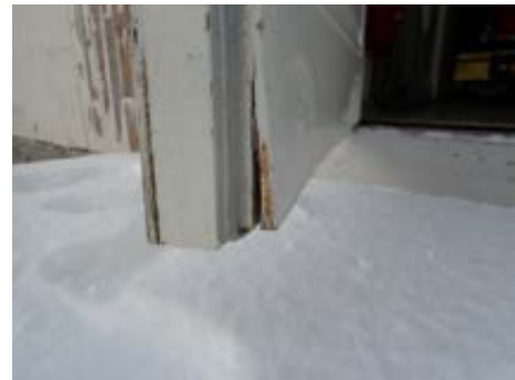
Skade i hovedinngangsdør
