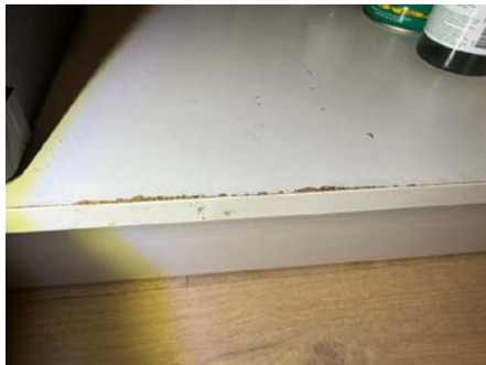
Fuktsvelling og bruksslitasje i kumskapet.
