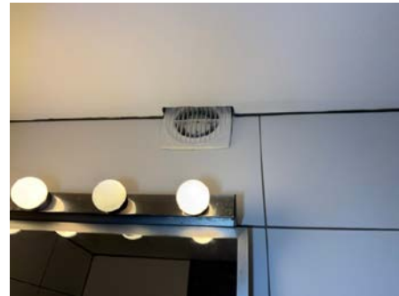
Himling på bad dekker noe av avtrekksviften
