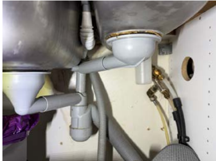
Røropplegg i kjøkkenbenk
