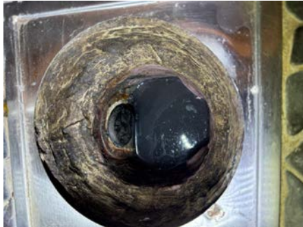
Eldre/opprinnelig støpejernsluk er modent for utskiftning.
