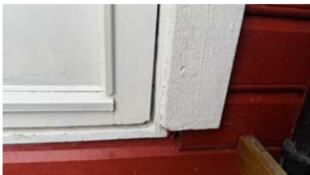
Terrassedør er ujustert. Bilde viser at det er tatt utsparring i dørens karm for tidligere justeringer.
