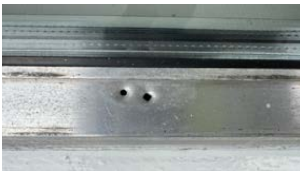
Glasslist med hull bør skiftes ut.
