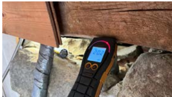
Det må sørges for at områder under bygget er godt ventilert.
