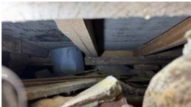
Eldre etasjeskille mot grunnen. Synlig borebilleaktivitet
