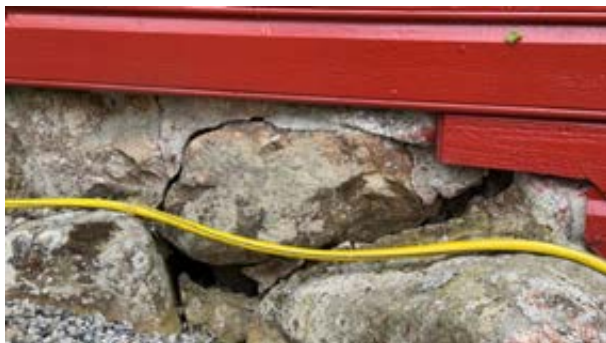
Registrert bevegelser i steinsetting/grunnmur.
