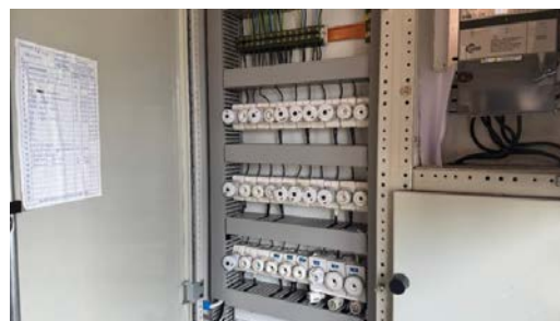
Sikringsskap med skrusikringer.
