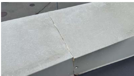
Beslag med laskeskjøter er ikke anbefalt løsning jf. SINTEF/Byggforsk.
