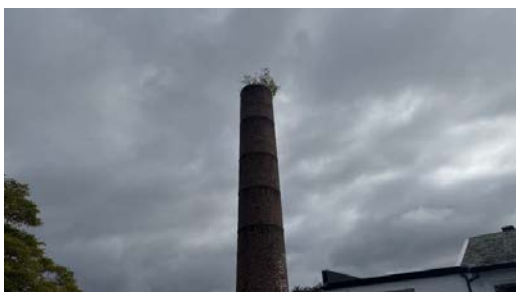
Pipen må kontrolleres av fagpersonell.
