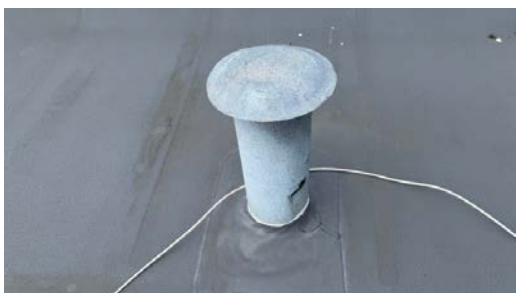
Takhatter i sinkutførelse kan ha begrenset restlevetid.
