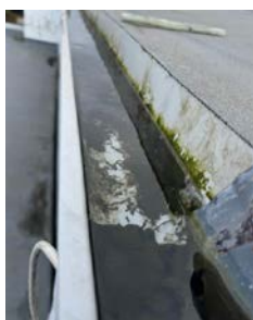
Stående vann kan tyde på at det er tett i takvannsnedløp.
