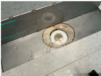
Sluk bad 2.etasje
