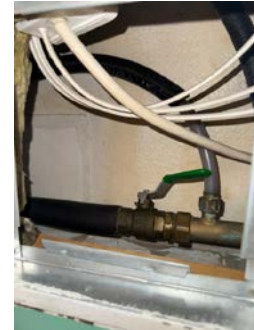
Stoppekran over himling på badet.
