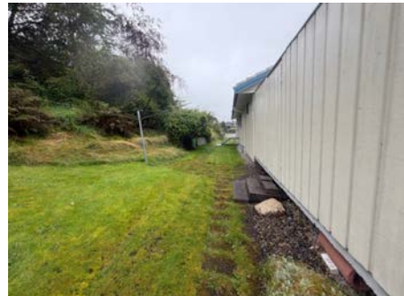
Terrenget har helning mot grunnmur.
