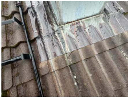
En kenkt takstein like ved skortstein. Bør skiftet ut eller tettes.
