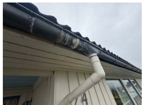
Her er det påvist liten lekkasje.
