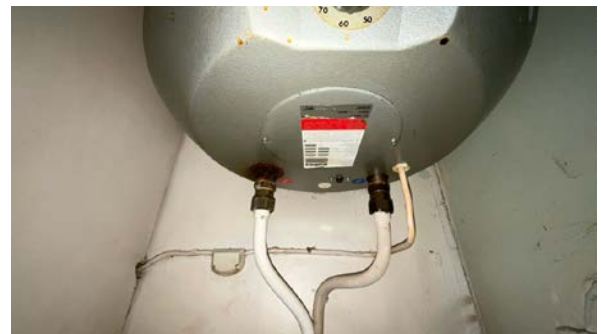
Synlige rustdannelser på koblinger.
