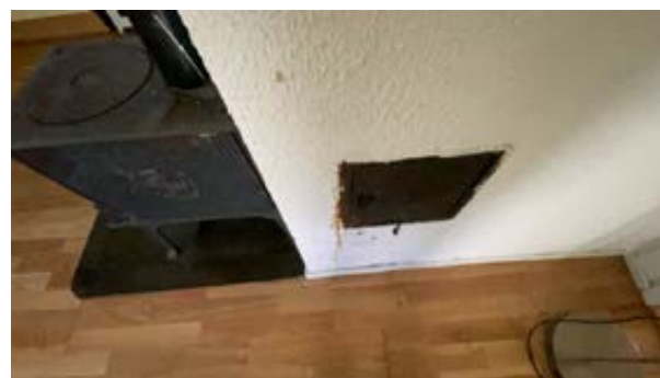
Brenbart materiale under sotluke på stue.
