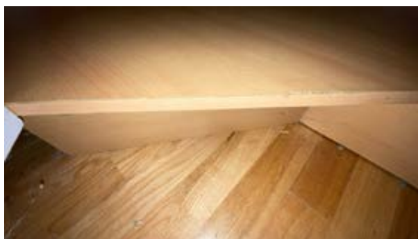
Mindre svell/fuktskade i skap under vask.
