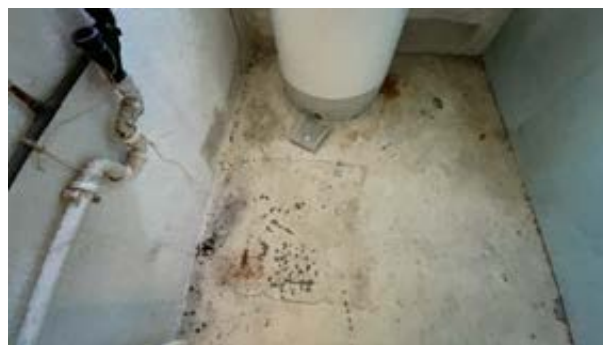
Ingen form for tettesjikt i våtsoner på gulv/vegger.
