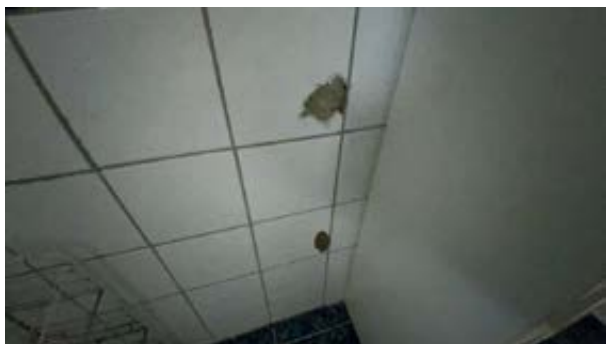
Skader på flere fliser.
