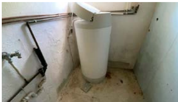
Varmtvannsbereder i vaskerom.
