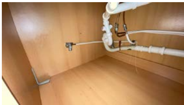
Lekkasje i vanntilførsel i henhold til eier.
