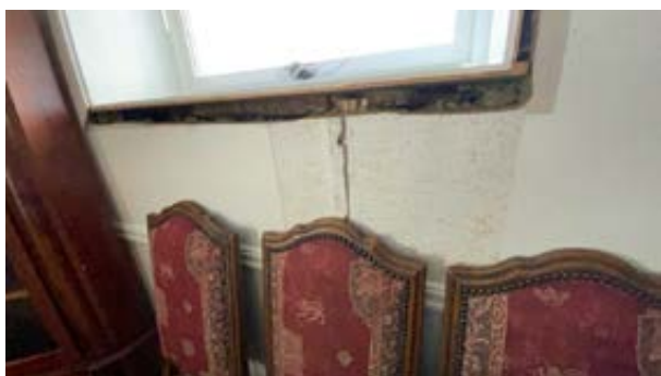
Skader på malt strie og manglende belistning.
