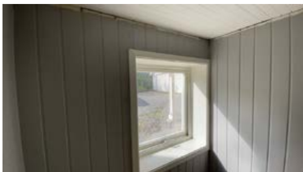
Manglende ventilasjon på noen rom.
