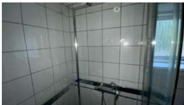
Manglende opplegg for dusjarmatur i dusjkabinett.
