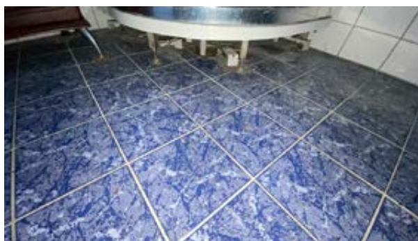
Manglende deksel på dusjkabinett.
