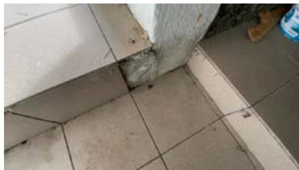
Manglende fliser på sokkel.
