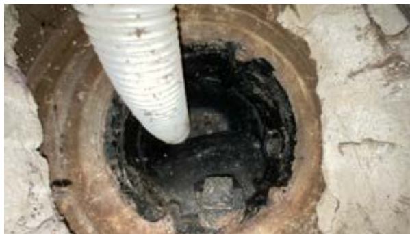
Sluk under dusjkabinett.
