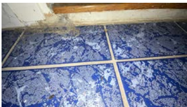
Kun bruk av silikon ved/under dørterskel er ikke tilfredsstillende.
