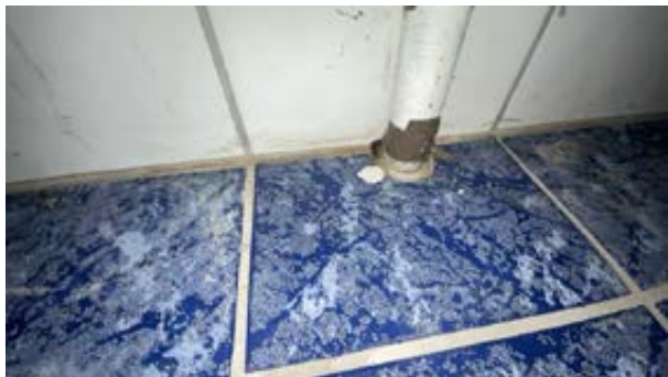
Ikke tilfredsstillende løsning ved rørgjennomføring gjennom tettesjikt.
