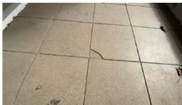
Sprekker/skade på flis.
