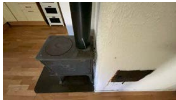
Ikke tilfredstillende avstand mellom ildsted og pipe.
