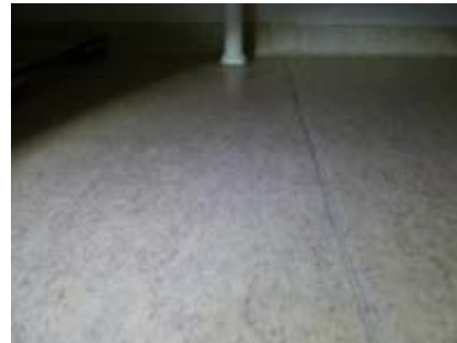
Sprekk i skjøte på gulvbelegg. Gulvbelegg har misfarging etter varmekabler.
