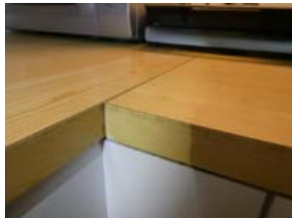
Liten avvik i skjøte på benkeplate
