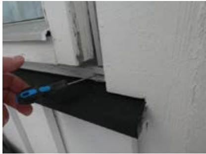
Vinduskarmer utvendig slitt
