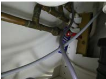
Kopper vannrør og stoppekran i kjøkkenskap
