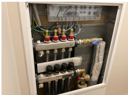
Kontroll av fordelerskap.
