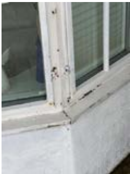
Slitasje og noe dårlig trevirke på noen vinduer.
