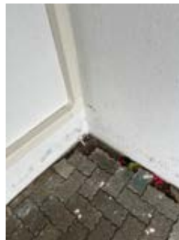
Det mangler stedvis noe belegningsstein
