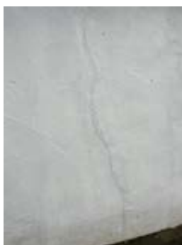
Noe sprekker i grunnmur. Tettet med fyllmasse.
