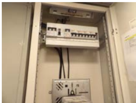
Sikringsskap i teknisk rom.
