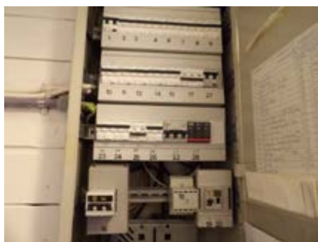
Sikringsskap i teknisk rom.
