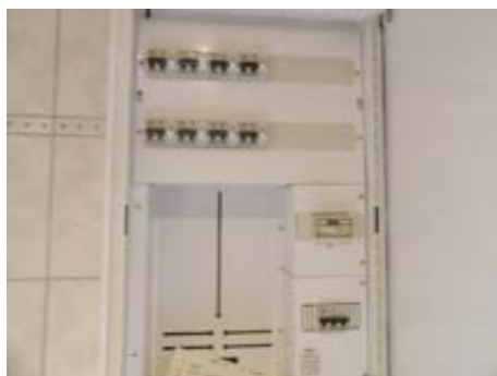
Sikringsskap på vaskerom leilighet 1.
