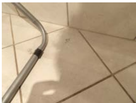
Små skader på fliser på gulv.
