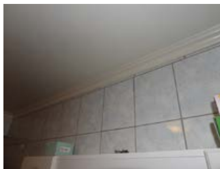
Det er lagt små flisebiter på vegger.
