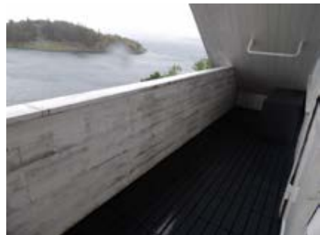
Altan på loft. Slitasje på tregjerde.
