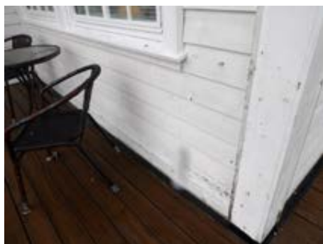
Noe slitasje på kledning.
