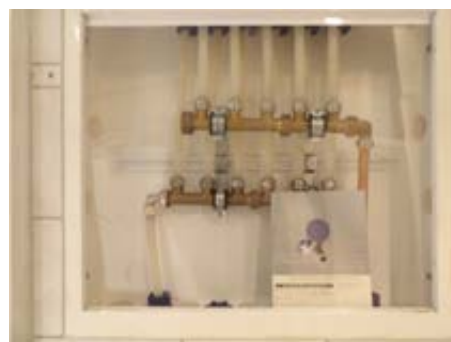
Rør i rør sentral på vaskerom leilighet 1.
