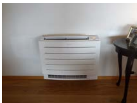
Varmepumpe i stue.
