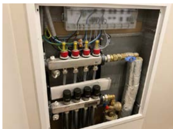
Kontroll av fordelerskap.
