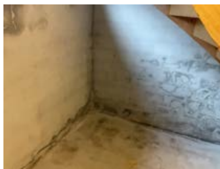
Spor av fuktighet på mur/gulv i kjeller.
