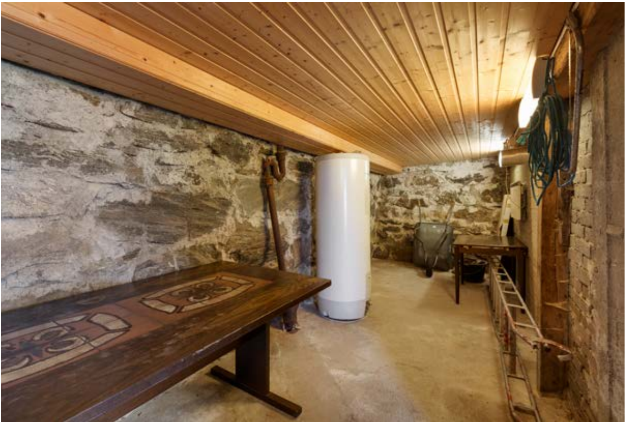
Kjeller med varmtvannstank på 300 liter fra 2012
