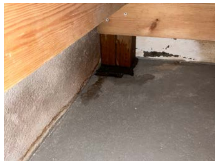
Synlig innsig av vann under kjellertrapp.
