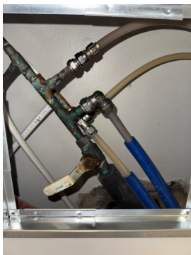
Stoppekran med synlig irr på rørene.
