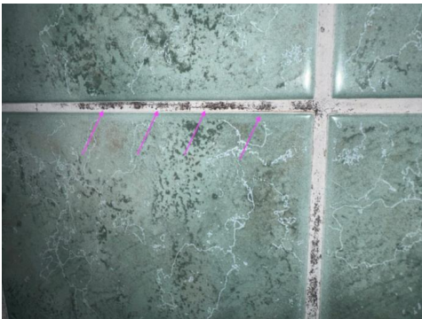
Det er svertesopp og riss i fuger.
