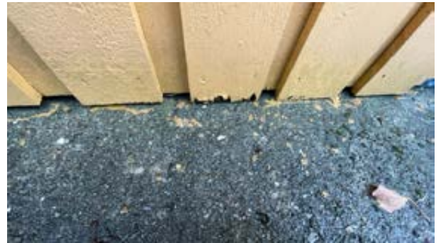
Stedvis råteskadet kledning.
