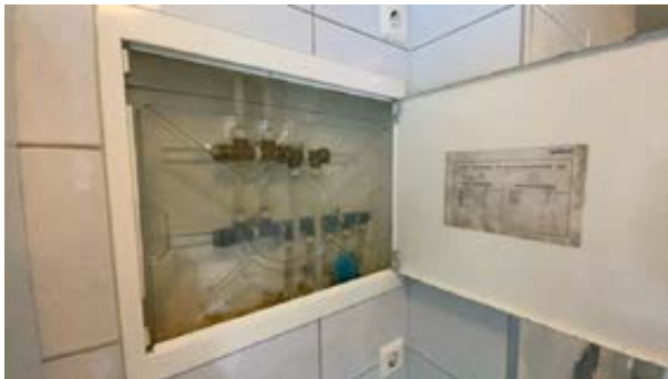
Rør i rør sentral.
