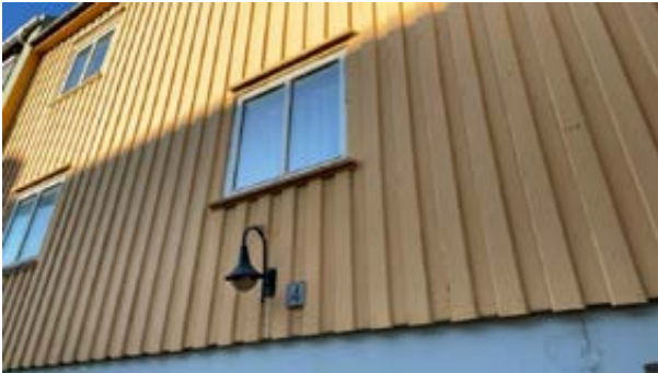
Vindu uten beslag/lufting.
