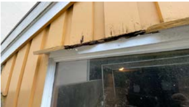
Råteskader på vannbrett over vindu.
