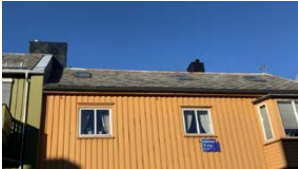
Manglende snøfanger mot offentlig fortau
