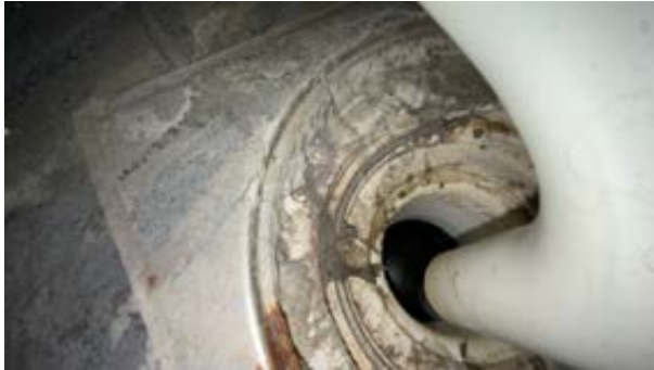
Plastsluk med synlig tettesjikt under klemring.
