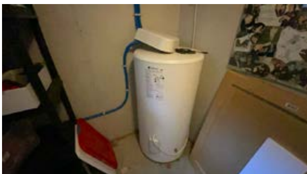
Varmtvannsbereder i bod sokkeletasje.
