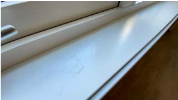
Svell/fuktskader på utforing.
