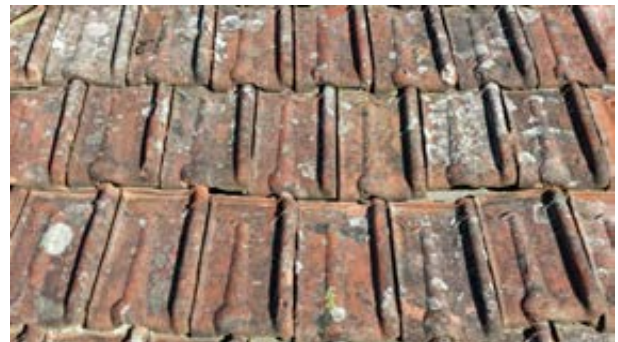
Løs takstein som følge av råte i underliggende leker.
