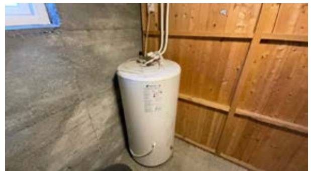
Varmtvannsbereder plassert i kjellerbod.
