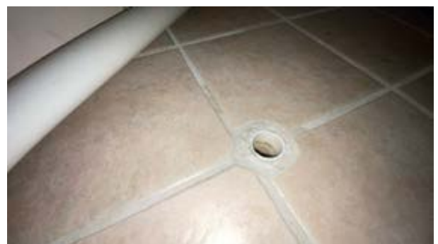
Åpen avløpsrør i gulv.
