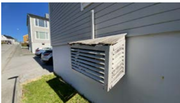
Utedel, omramming/tildekking i dårlig forfatning.
