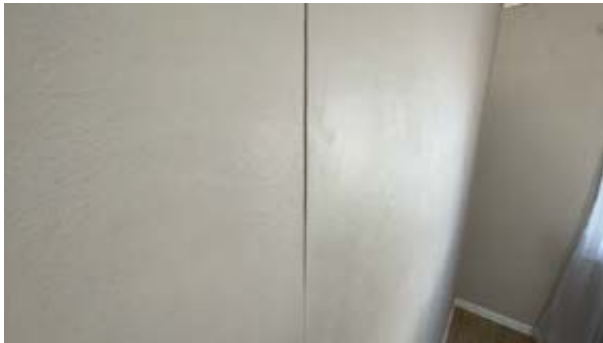
Stedvis løse tapetskjøter.
