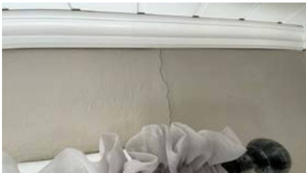
Stedvis sprekker i tapet.
