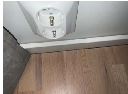
Det er åpning mellom list og gulv. Kan enkelt utbedres lokalt.
