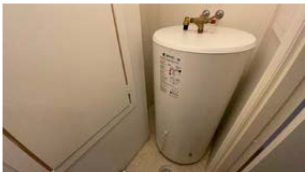
Varmtvannsbereder av merket «Møretank».
