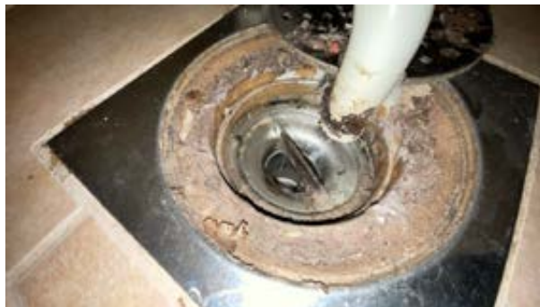
Sluk under dusjkabinett
