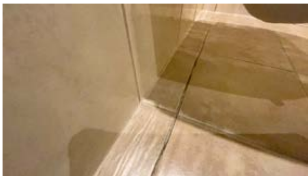
Sprekker/løs gulvflis under veggghent toalett.
