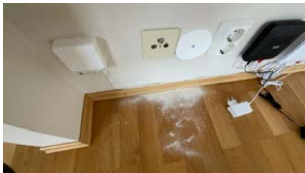
Hull på stue/kjøkken var ikke mulig å fuktkontrollere grunnet type materialer.
