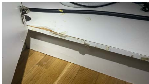
Mindre skade i benkeskap.
