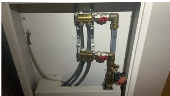
Rørskap til radiatorer.
