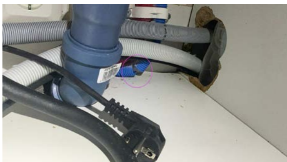
Sprekk i varerør i benkeskapet. (Rosa sirkel).
