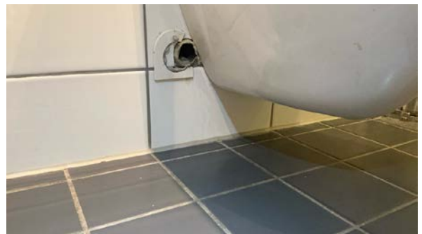
Siklemikk (deksel) til dreneråpning er borte.
