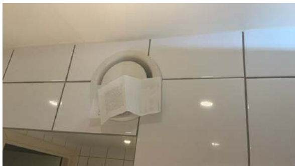
Test av avtrekk. Papiret henger.
