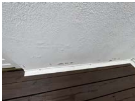
Sprekker i puss på yttervegg mot nabo. Ytterveggen støter mot ytterveggen til aktuell seksjon.
