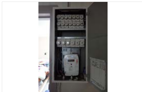
El-skap med krussikringer
