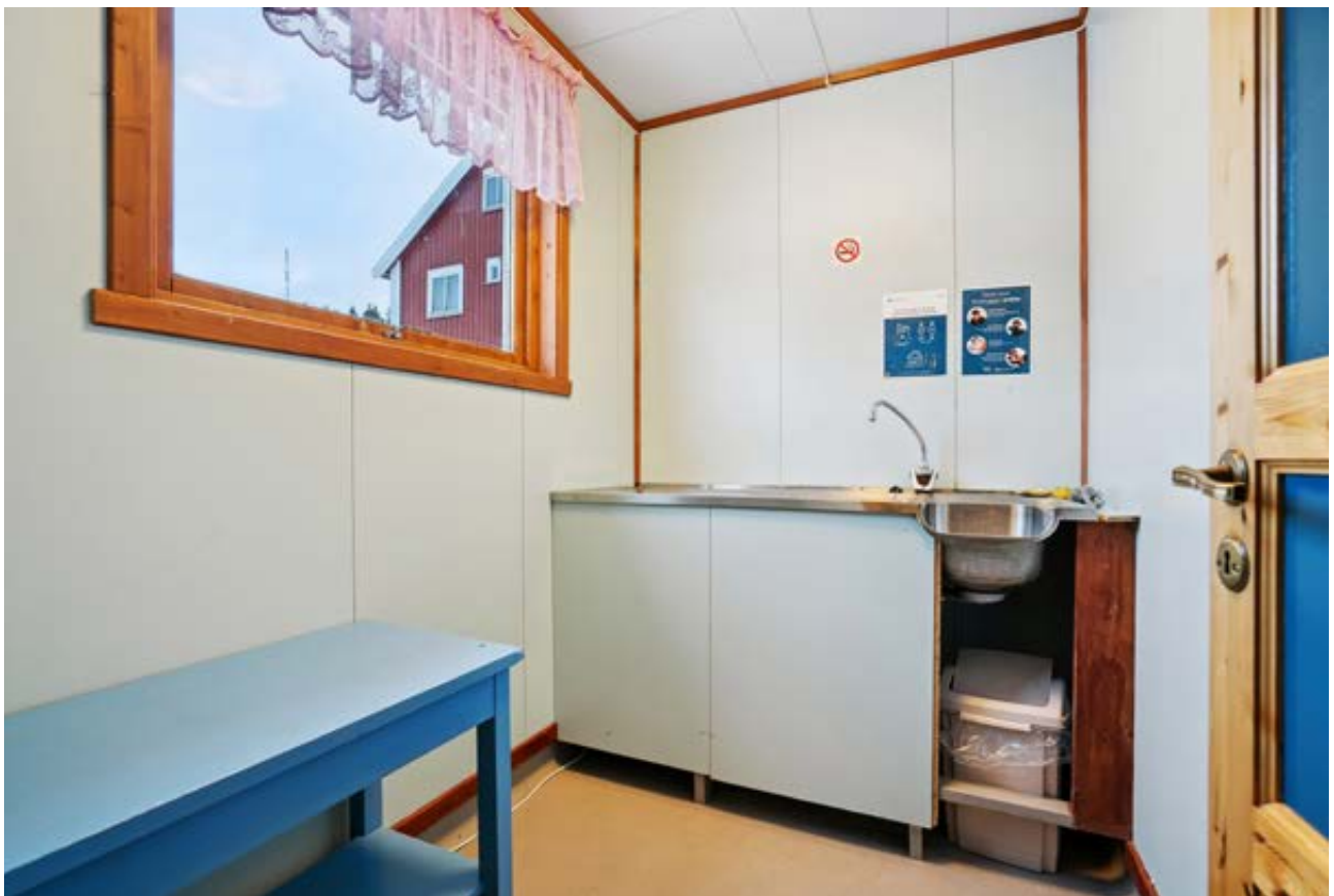
Sanitæranlegg i service bygget
