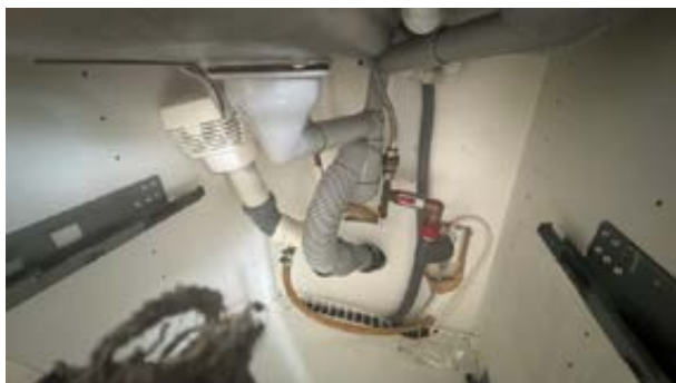
Slange fra bereder er ikke koblet til avløp.
