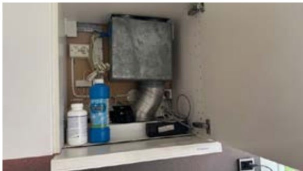
Ventilatorens motor kan være fra byggeår.
