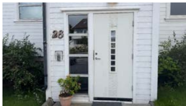
Felles entredør er nyere enn bygget, denne har påbegynte svekkelser.
