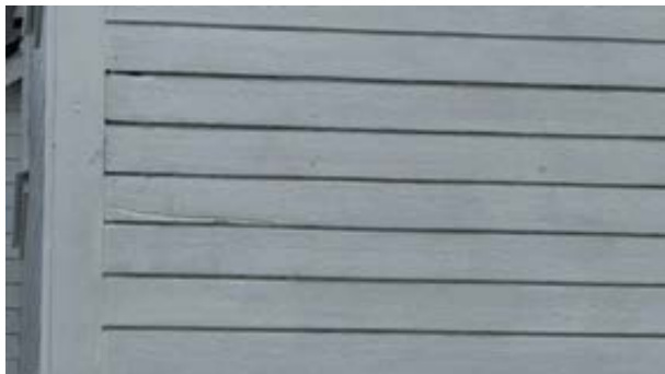
Stedvise råteflekker i kledningen.
