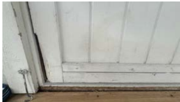
Terrassedør har mekanisk skade i nedre del av dørblad.
