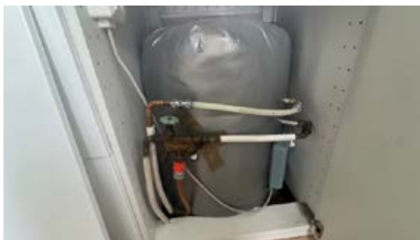
Varmtvannsbereder fra byggeår.
