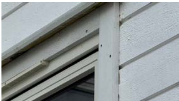
Skruer er skrudd for dypt inn i treverket (skrue og treverk skal være plant/jevnt)
