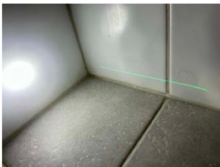
Sprekk i flis i hjørne
