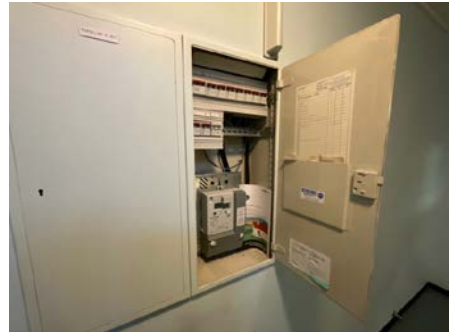
Sikringsskap plassert i felles trappegang.
