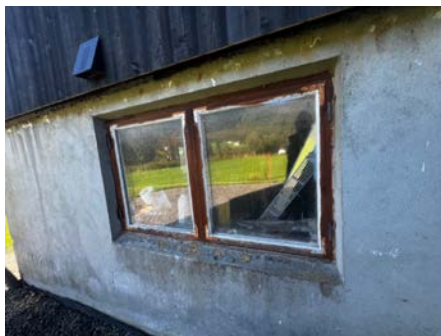
Gamle utslitte vinduer i kjeller.
