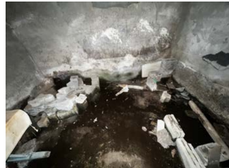
Deler av område med sulfatskader.
