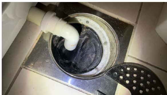
Sluk på bad
