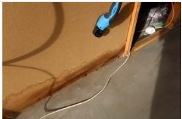
Sponplater er fuktskadet i nedre nel mot betonggulv.
