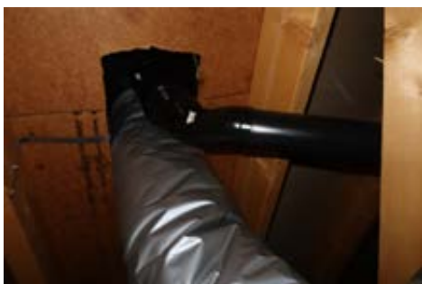
Lufting kloakk til over yttertak.
