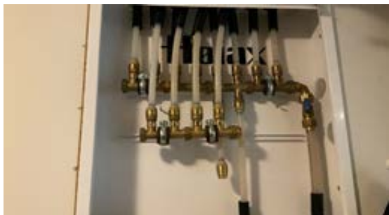
Fordelerskap med rør i rør opplegg.
