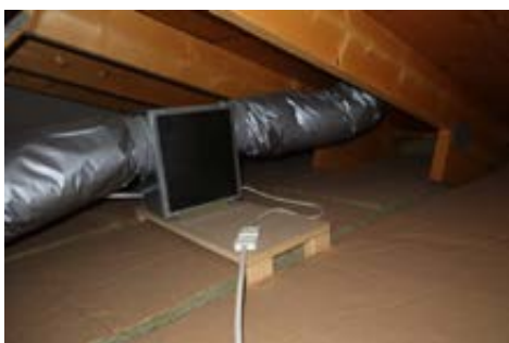
Motorvifte plassert på kryploft.
