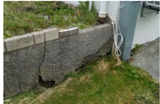
Bed/forstøtningsmur har sprekker.
