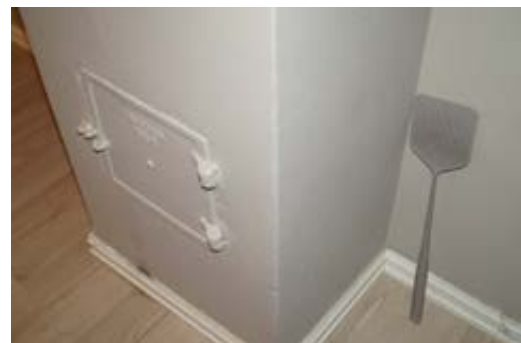
Ildfast plate mangler på gulvet under sotluke/feiluke på pipe.
