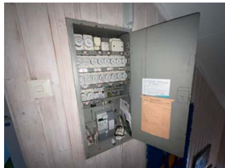
Sikringsskap plassert i loftet.
