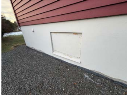
Eksempel på manglende klemlist over grunnmursplast.
