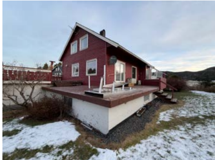
Veranda mangler rekkverk.
