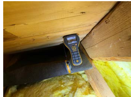
12,4 vektprosent i undertaket er tørt trevirke.
