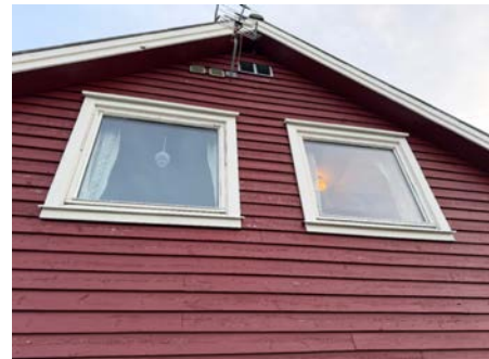
Vinduer i loft mot vest, punktert glass.
