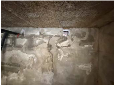
Eksempel på salt/kalkutslag i tilbygg.
