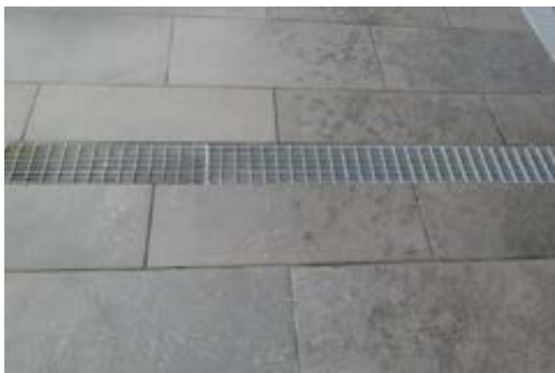
Stedvis bom under fliser inntil drenerister.
