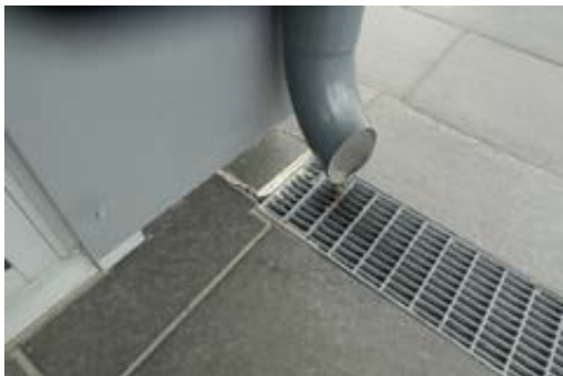
Løs flis i enden på drenerist.
