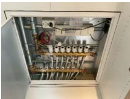
Fordelerskap for vannbåren gulvvarme.
