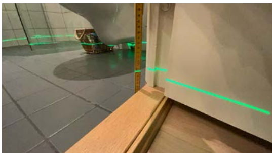
Høydeforskjell (flis ved terskel)
