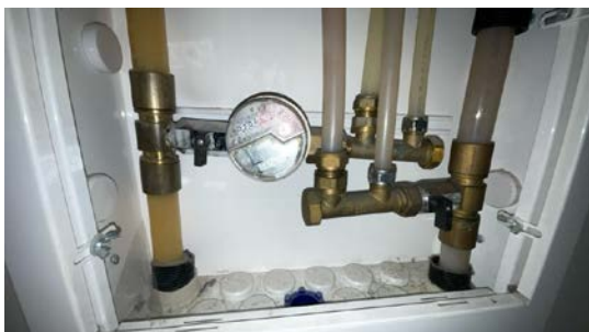
Fordelerskap i bod
