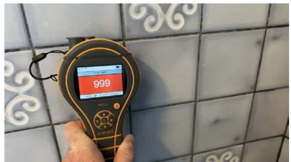
Høyt fuktutslag på veggen i dusjen
