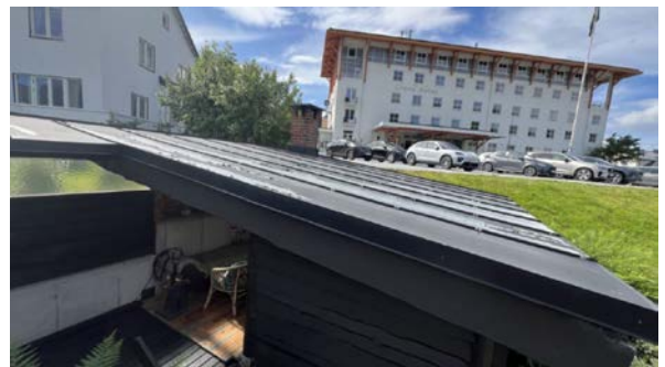
Plane metallplater på taket med en del slitasje
