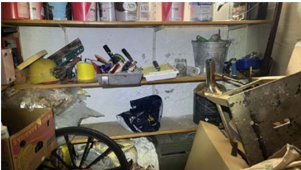
Saltutslag på murvegg i ene boden i kjelleren
