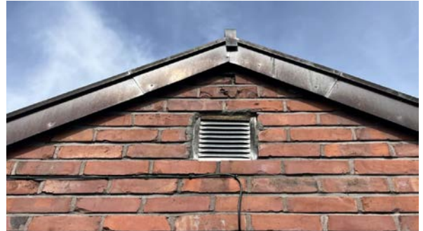
Sprekker i teglstein og fuger.
