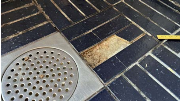
Løs flis ved sluket
