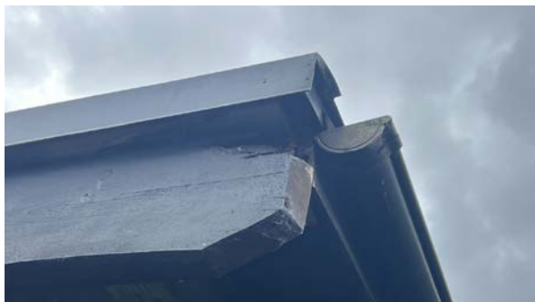
Råteskade på utestuen
