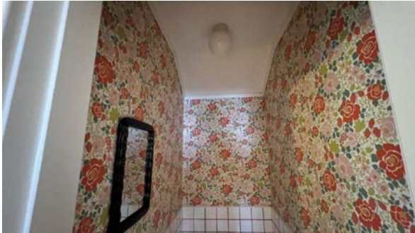
Rommet mangler ventilasjon
