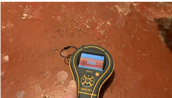
Høyt fuktutslag på gulvet på vaskerommet
