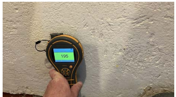
Lave fuktverdier målt på murvegg
