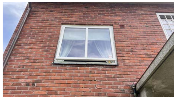
Sprekker i teglstein og fuger
