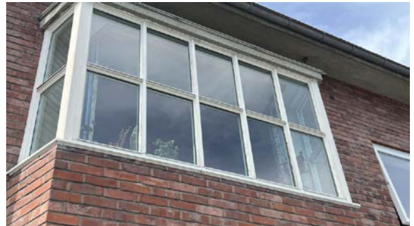
Værslitt vindu på stuen
