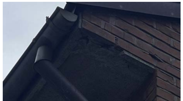
Observert skader i betongen under takutstikket
