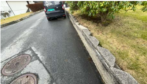
Muren har skjevheter og løse steiner.
