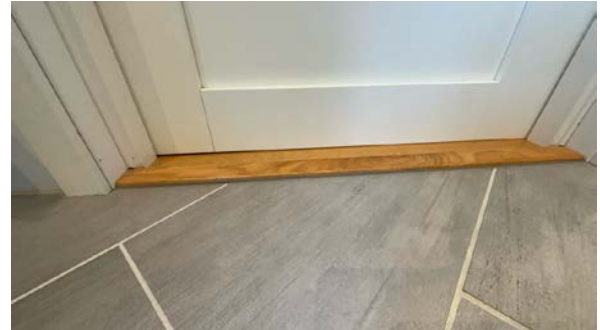
Døren er noe skjev mot karm og dette hindrer luftstrømmen noe
