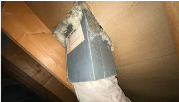
Det er observert korrosjon på den ene takhatten på loftet.
