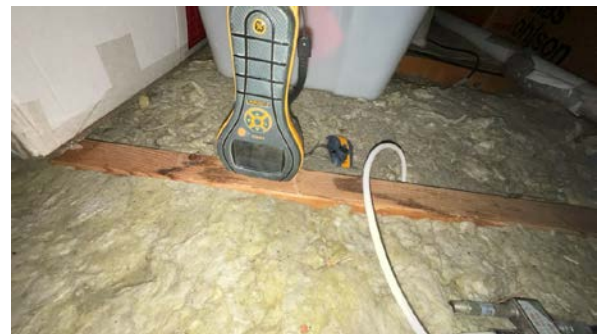
Tørr fuktskjolde på loftet.
