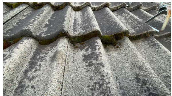
Mose på taket og takstein er slitt.
