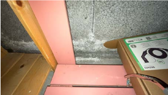
Saltutslag på boden.
