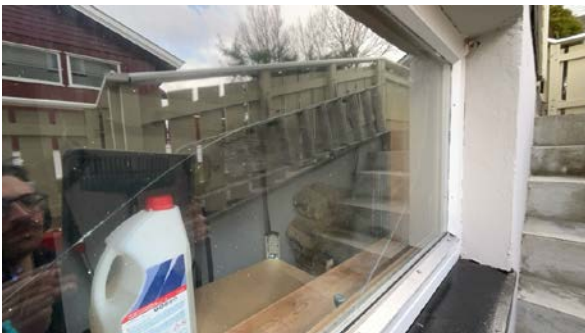
Sprekk i glass på vindu.
