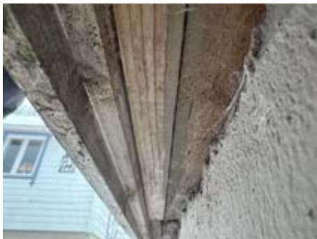
Mangelfull luftespalte og drenering i veggkonstruksjonen ned mot grunnmur.
