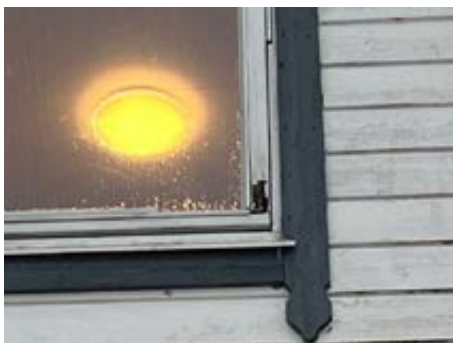
Påvist råteskadet vindu på soverom i loft mot sør.
