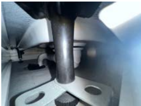
Bilde av sluk under dusjkabinett.
