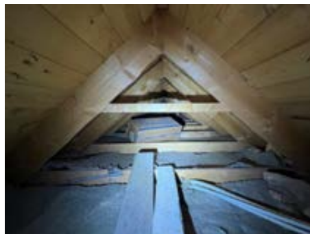
Bildet viser det ikke er montert dampsperre på varm side mot isolasjonen.
