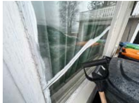
Det er registrert to vinduer med sprekker i glass i kobla vinduer i kjeller.
