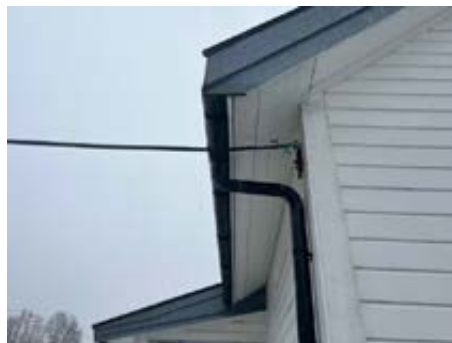
Manglende luftespalter på rafter på østsiden av boligen.
