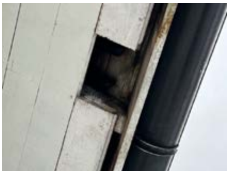
Raftekasse på baksiden av huset mot øst. Det er registrert noe råde oppunder taktro.
