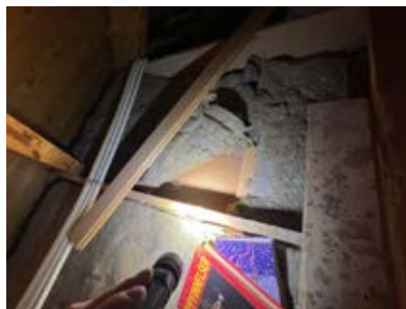
Manglende dampsperre på varm side av isolasjonen i kaldloftet.
