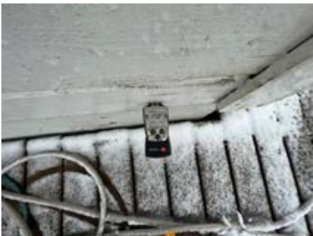
Høyt fuktinnhold i nedkant av kledning mot sør.
