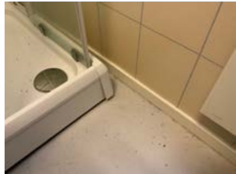
Ufagmessig montering av våtromsplatene. Ikke i i henhold til monteringsanvisning fra produsent.
