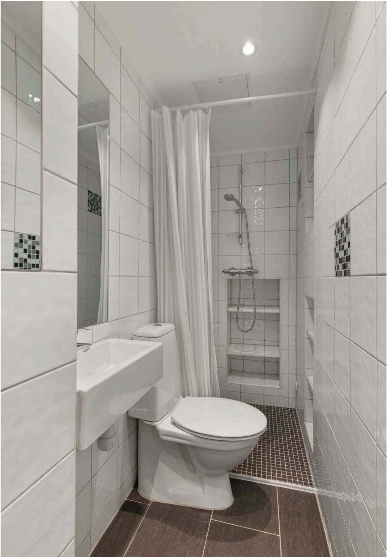
Flislagt bad med servant, toalett og dusjvegger/hjørne. Malt himling med downlights. Elektriske varmekabler på gulv. Elektrisk styrt vifte. Tilluft via spalte ved dørterskel.
