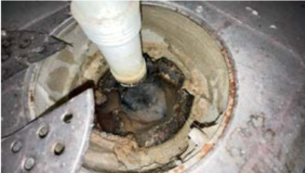
Sluk under dusjkabinett.
