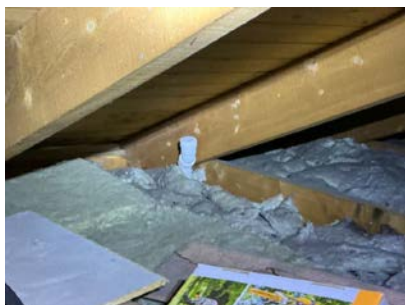
Lufting av kloakk er ikke luftet over tak.
