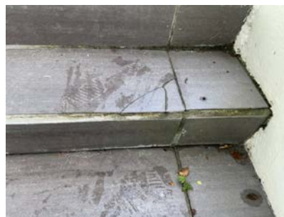
Skade på noen fliser.
