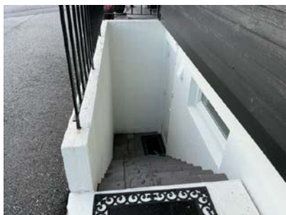
Hånd-rekke er ikke montert på trapp til kjeller.
