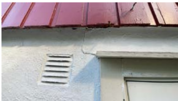
Sprekker ved opplagring over /ved vindussmyg
