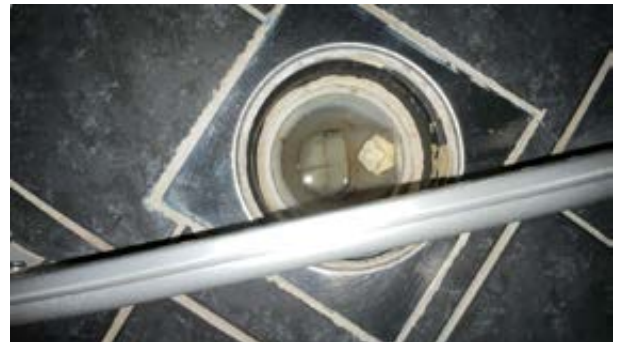
Sluk med utforming som ikke viser tettesjikt under klemring.
