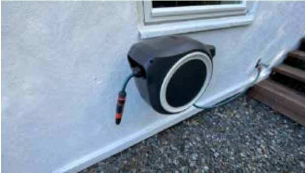
Utvendig frostsikker vannuttak.
