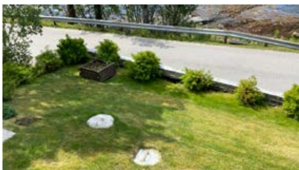
Septiktank med 2-kammer på plen mot vest.
