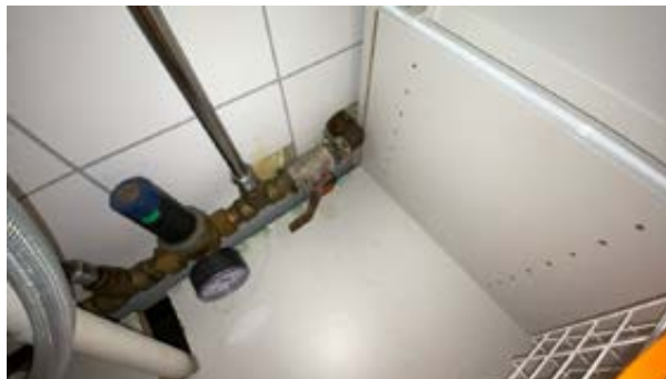
Hovedkrane i vaskerom.
