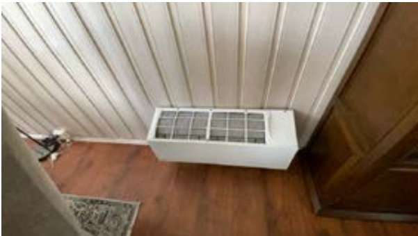
Varmepumpe i stue/kjøkken.
