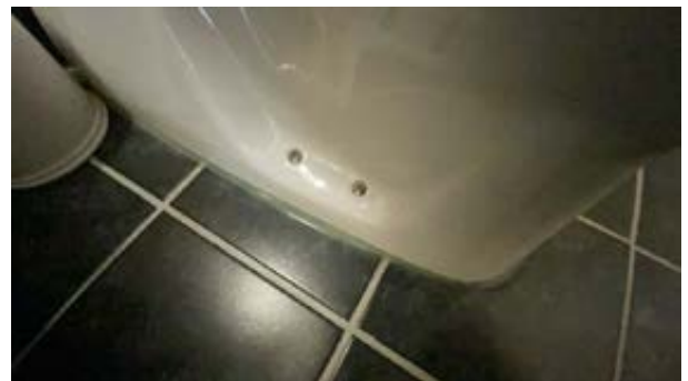
Punktering av membran ved innfestning av toalett.
