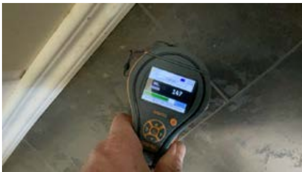
Det ble målt 14,7 vekt% fukt i bunnsvill ved bruk av piggmåler.
