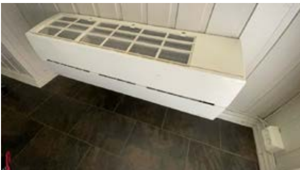
Varmepumpe i kjeller.
