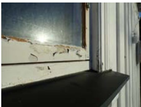
Værslitt Vindu i vf
