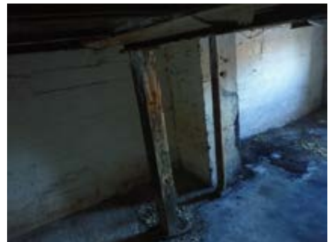
Råteskader i søyle og drager
