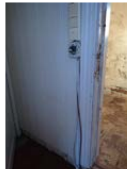
Skade i dørkarm + katterull i dørblad
