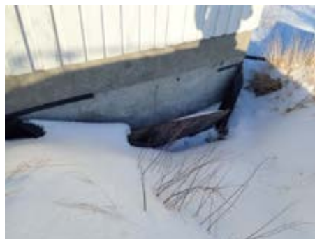
Del av grunnmursplastener løsnet fra grunnmuren
