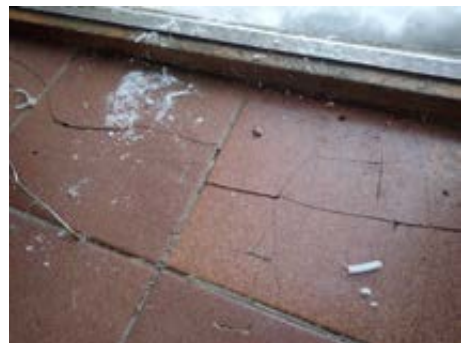
Skader i fliser innenfor hovedinngang
