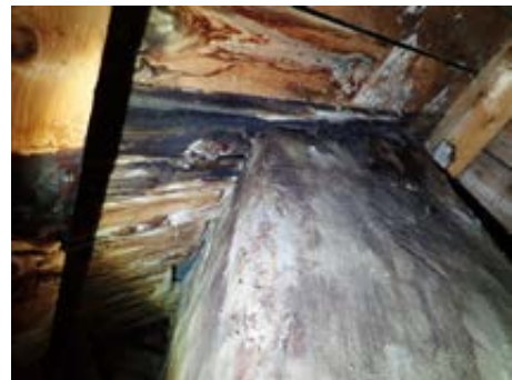
Fukt/råteskadet trobord ved pipegjennomføring
