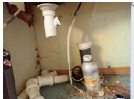
Utkoblet avløpsrør i kjøkkenbenk.
