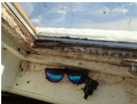
Råteskadet vindu på soverom
