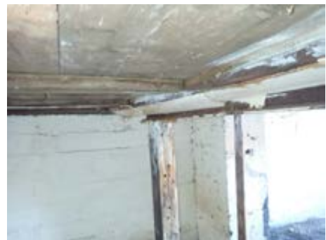
Sopp og råteskader i søyle og drager
