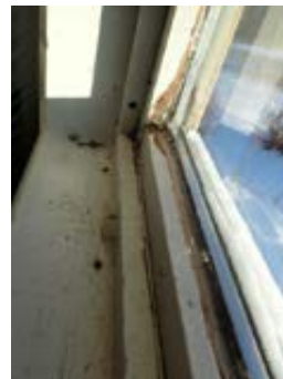
Råteskadet vindu i trapperom loft.
