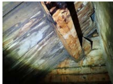
Fukt/råteskadet trobord ved pipegjennomføring
