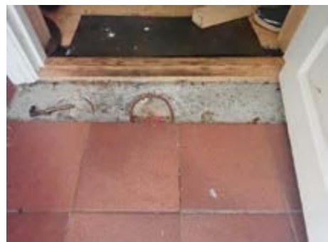
Avslutning av flis mangler
