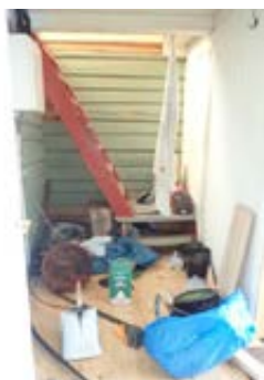
Loftrapp uten rekkverk og håndlist
